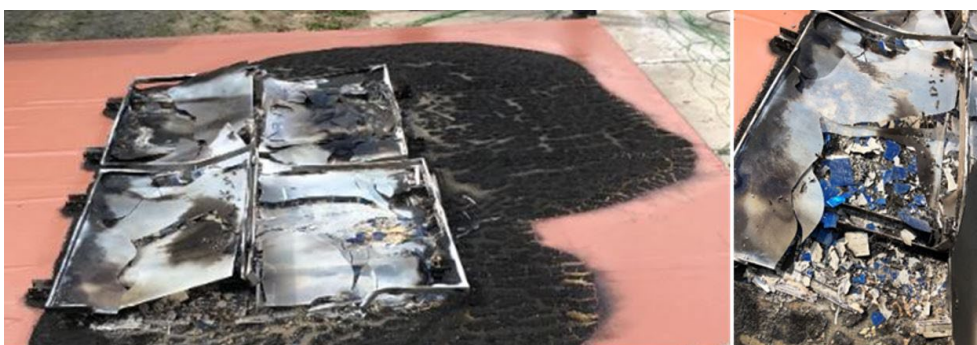
Figuur 4-2 Gebroken glasplaten van de zonnepanelen bedekken zonnecel-scherven. Zonnecel-scherven liggen onder de glasplaten en zijn pas zichtbaar nadat de glasplaten zijn verwijderd (rechter foto). Door de verhitting van het glas breken de glasplaten niet meer zoals thermisch gehard glas hoort te breken (verbrijzelen).
