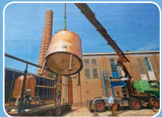
Aankomst ketels bij het ketelhuis. De bierbrouwerij zal hier de Veluwe Schavuit gaan brouwen.
